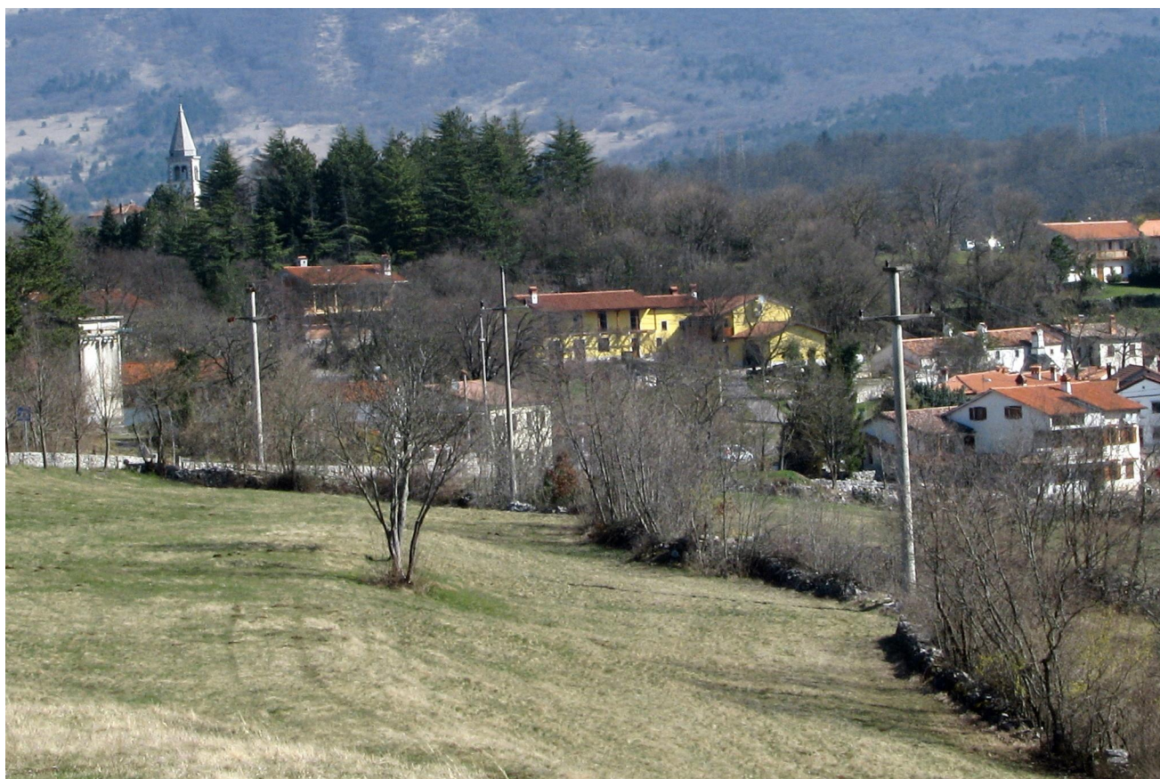
Slika 22: Nevarni(betonski) podporni srednjenapetostni daljnovod s pokončnimi izolatorji v odprti kulturni krajini pri Škocjanu. Zaradi načina lova velike uharice Bubo bubo , so najbolj nevarni stebri, ki so postavljeni v odprto kulturno krajino.
