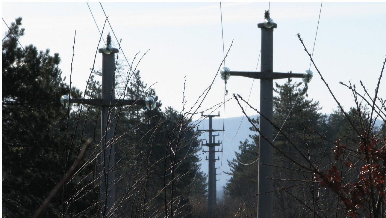
Slika 21: Nevarni betonski zatezni srednjenapetostni daljnovod z visečimi izolatorji med Lisičino in Škocjanom
